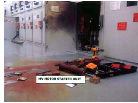
จุดเกิดเหตุ Arc Flash บริเวณตู้ควบคุมมอเตอร์
